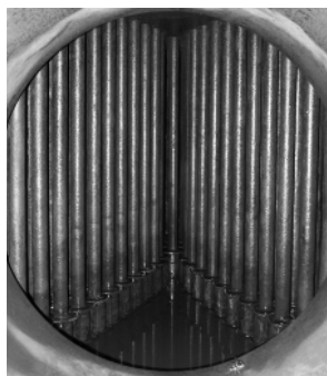
Рис. 9. Блок циклонов после полной очистки
