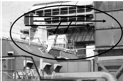
Рис. 6. Система охлаждения двигателя после доработки
